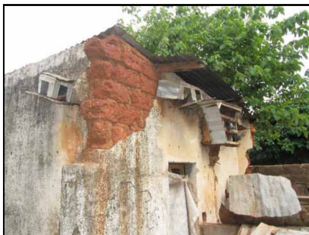
Photo 1 : Poulailler à toit délabré vu de l'extérieur
